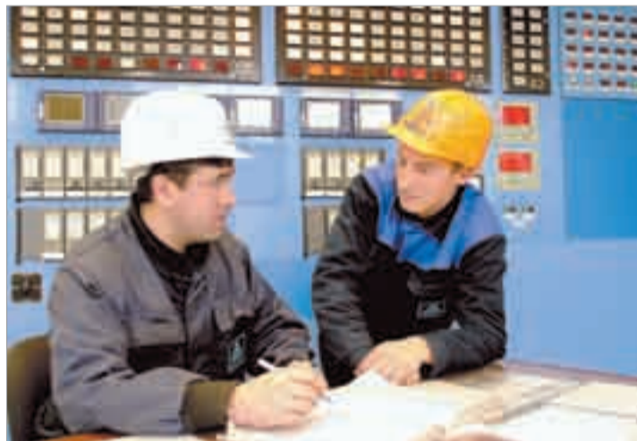
Ведущий инженер-электроник Ильдар Тазеев и оператор технологических установок Алексей Конюхов у главного щита КИПиА управления этиленопроводов.
