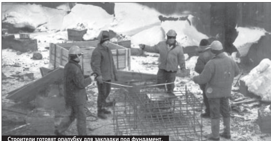
Строители готовят опалубку для закладки под фундамент, на который будут смонтированы металлоконструкции
